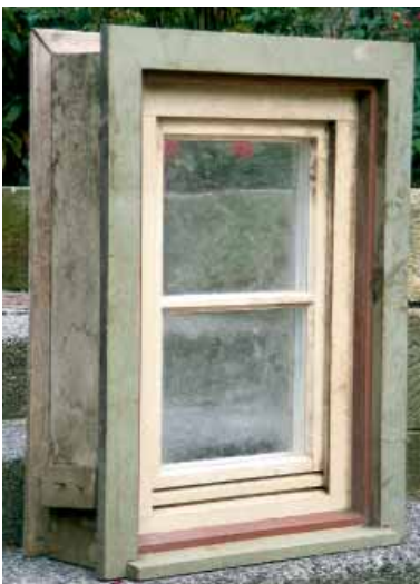
Ein „Dachbodenfund“: das original erhaltene barocke Kastenfenster aus einem Weingärtnerhaus im Remstal.
