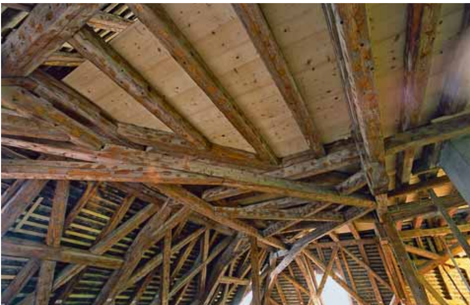
Ein Blick in den Problembereich des Dachgebälks.
