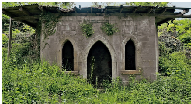
Spitzbogige Fenster und Eingang des Teehauses. Statt des zweiten Stockes gibt es nur noch ein Notdach.
