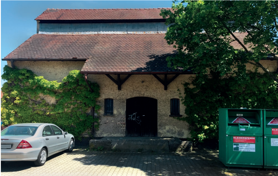
Üppiges Grün verdeckte den traurigen Zustand der Lagerhäuser vor der Renovierung.
