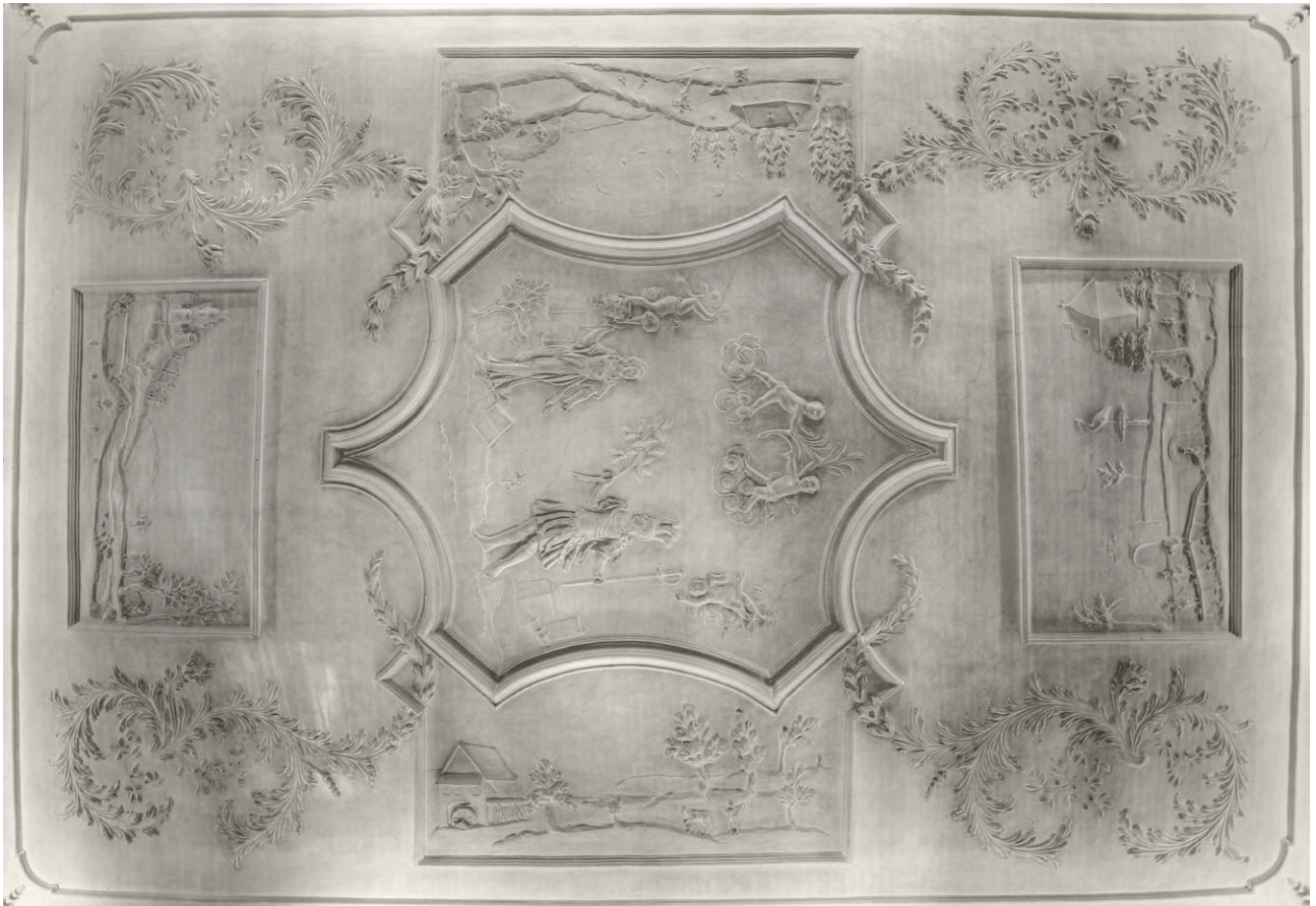
Die Decke der Walfischia, stark verschmutzt und rissig vor der Restaurierung.
