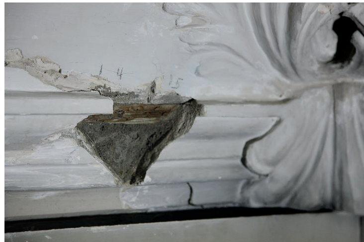
Sprengeungen am Rhein haben mittelbar ganze Brocken aus dem Stuck gelöst.
