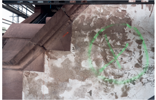
Wassereintritt und ein oberflächenversiegelnder Anstrich haben den Putz stark beschädigt.
