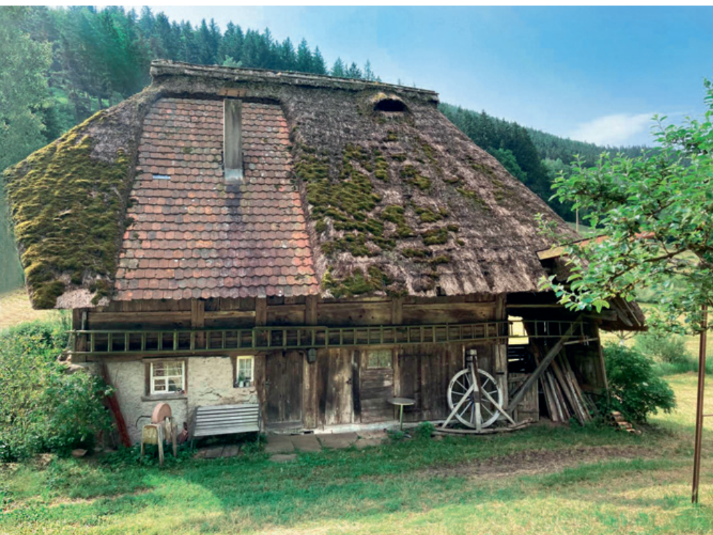
Schwarzwaldromantik pur: Die Mühle vor der unbedingt notwendigen Dacherneuerung.
