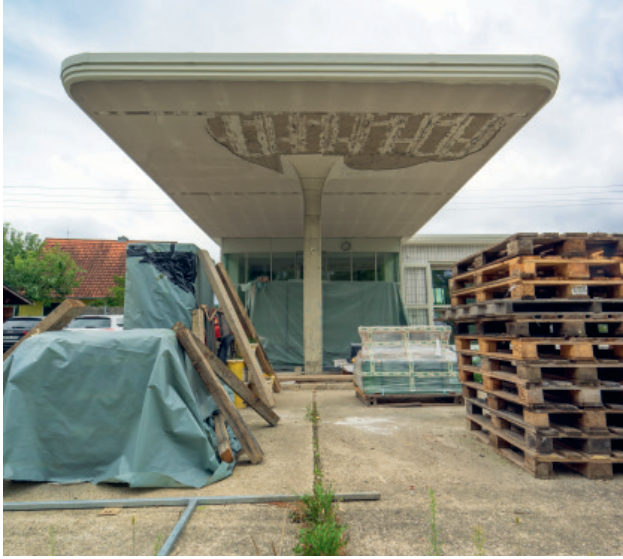
Das prägende Vordach mit noch deutlich sichtbaren Schäden.
